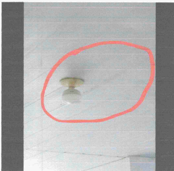
Descendo água pelo forro próximo a luz
