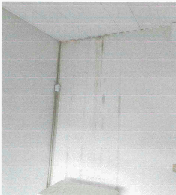
Vazamento telhado e escorrendo pela parede.
